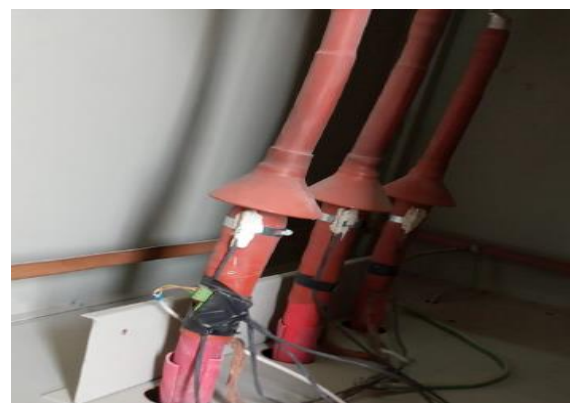
شکل (۶): نصب دستگاه بر روی سرکابل های داخلی
