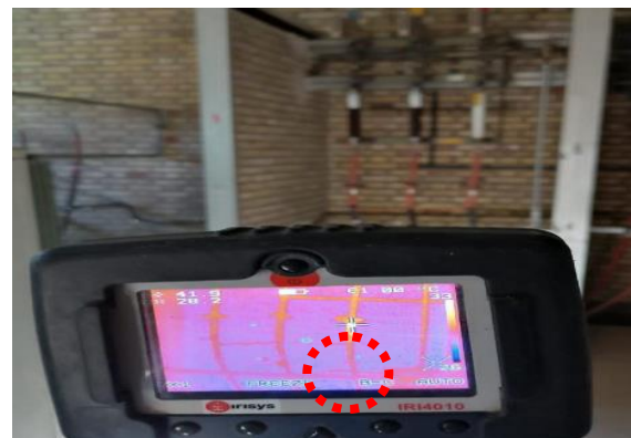
شکل (۷): ترموگرافی سرکابل در شرف خرابی
